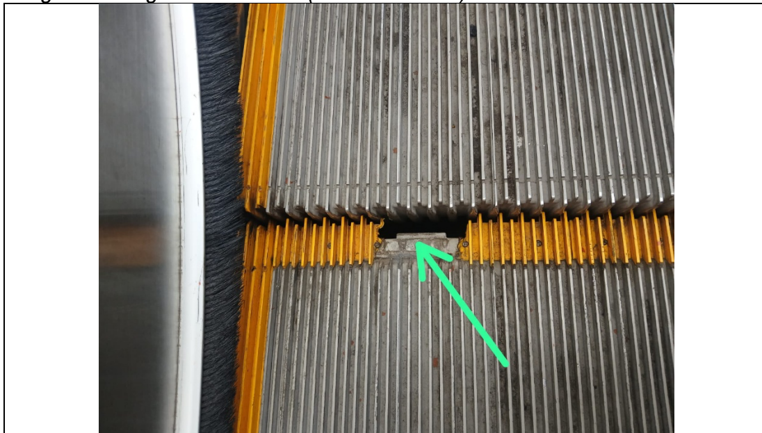
Imagen 6. Imagen de inserto dañado OT5706.
