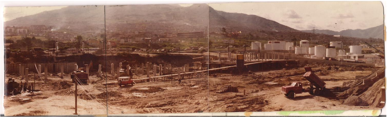
Construcción de la Terminal de Buses y Taxis Intermunicipales de Medellín "Mariano Ospina Pérez" (Terminal del Norte)
